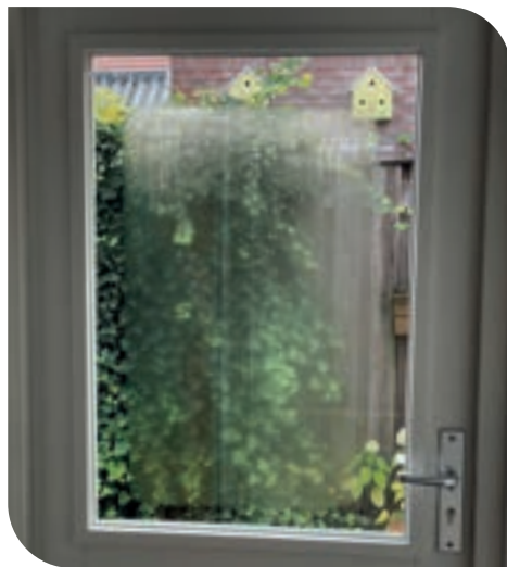
Condensvorming aan de kamerzijde.
